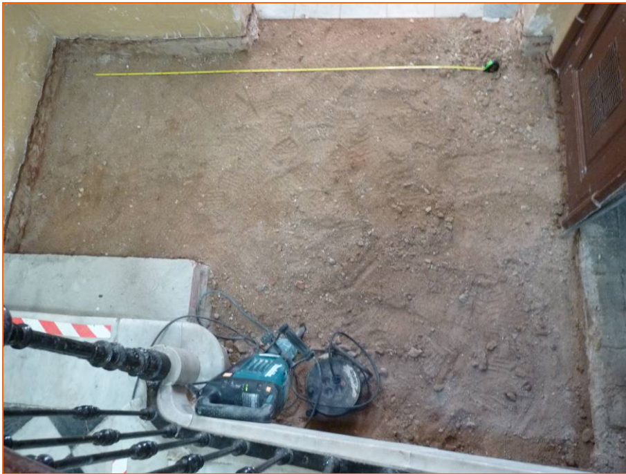
Foto 5. Rebaix finalitzat de la cota i punt d'inici d'excavació del fossat. UE.2.
